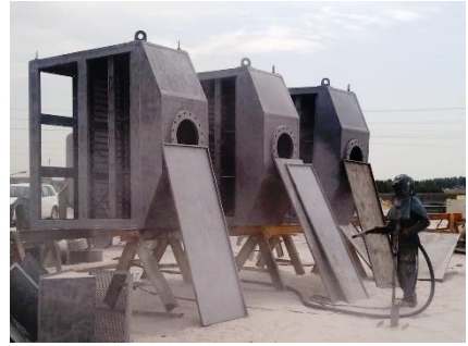
فیلتر های ورودی کمپرسور توربین گازی
